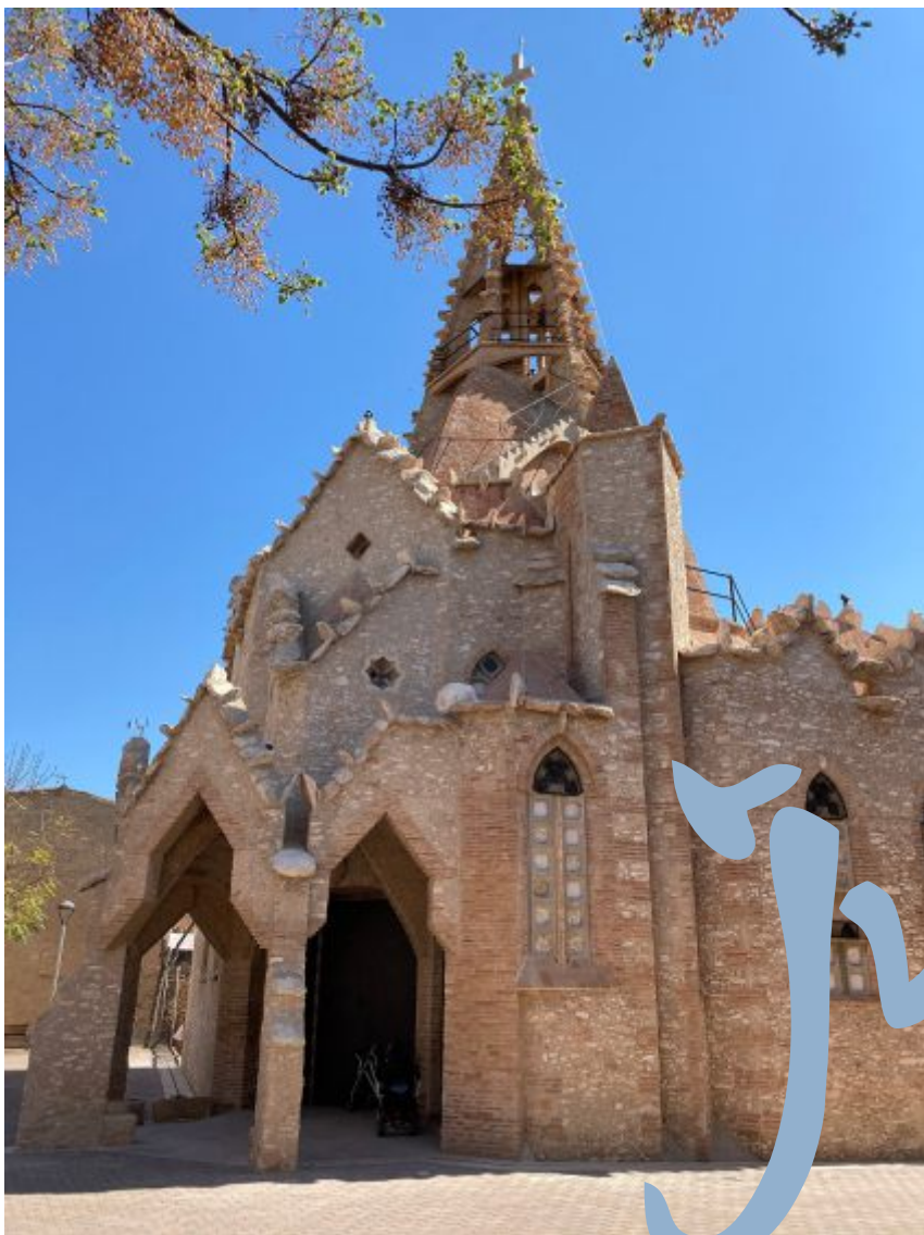
Imatge de l'església de Vistabella un cop restaurada la façana. Foto arxiu.
